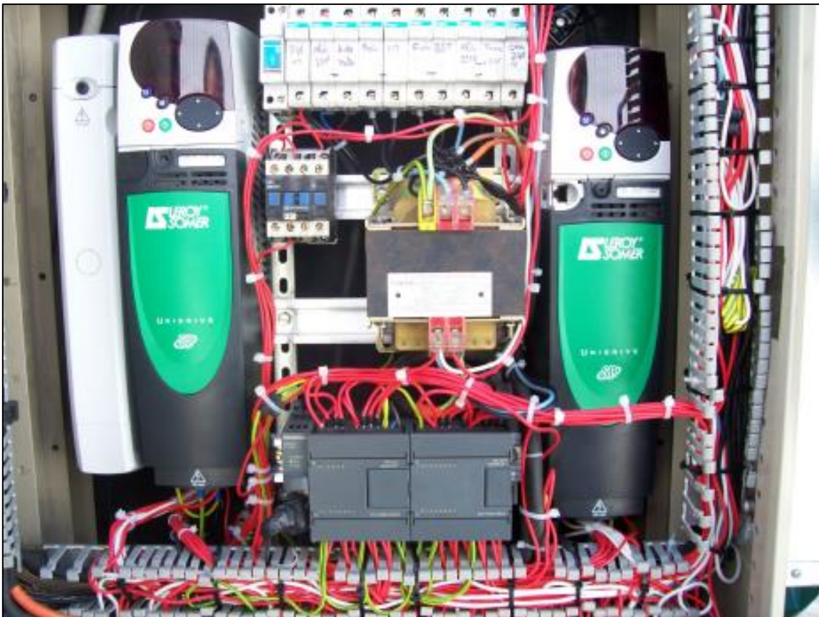
Armoire électrique (en cours de montage) de la machine volante (Les machines de l'île à Nantes)
